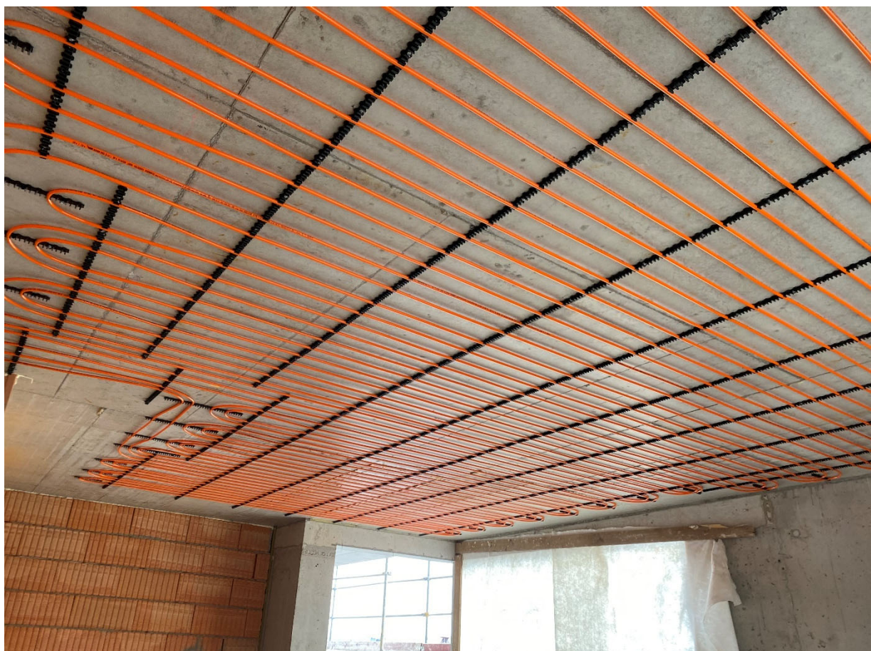
Stropní chlazení bytových domů Šantovka Living Olomouc
